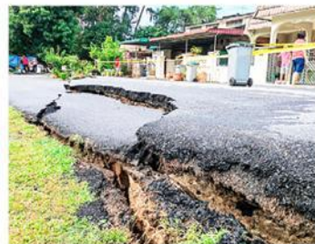
Keadaan rekahan pada jalan akibat kejadian tanah runtuh yang berlaku.
