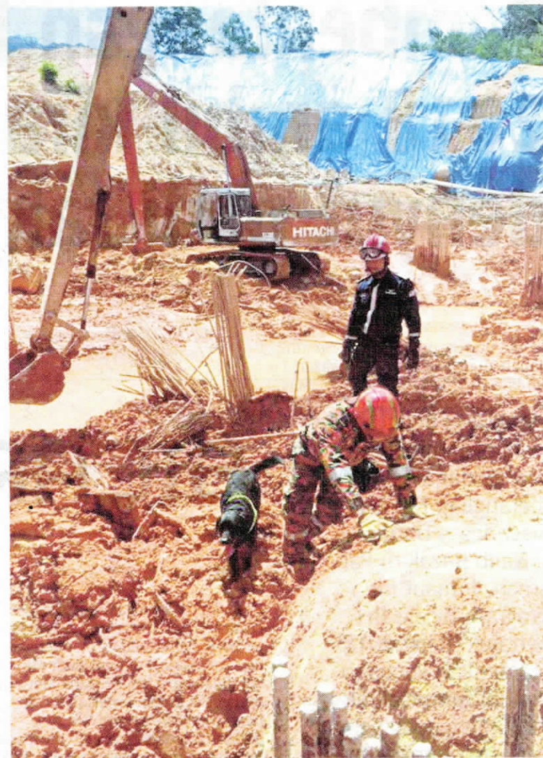
Anggota penyelamat membuat kerja scanning bagi memastikan tiada lagi mangsa yang tertimbus sebelum operasi ditutup sepenuhnya dalam kejadian tanah runtuh di tapak pembinaan Lembah Permai, Tanjung Bungah.
